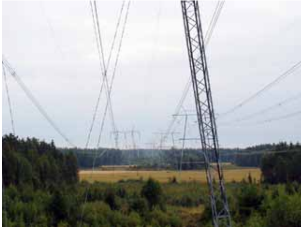
Rinnakkain kulkevat 110 kV:n ja 400 kV:n linjat Salossa
