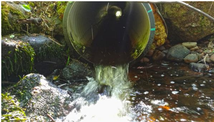
Kuva 2. Puroon liian korkealle asennettu tierumpu estää kalojen pääsyn kutupaikoille. Kuva: Jussi Aaltonen, Valonia.
