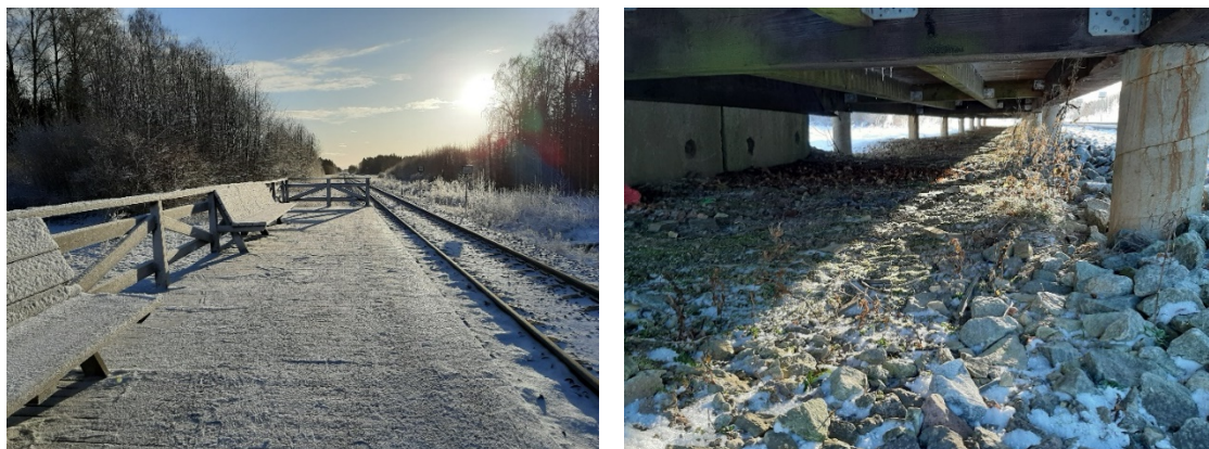
Kuva 14. Puupintarakenteinen betonipilareille perustettu laiturin kuvattuna Viron rautateillä. Kuvat: Maunu Tast.
